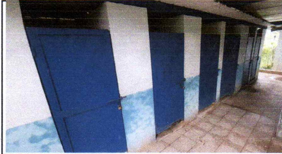
FOTO 1: Mantenimiento a estructura (lijado, cambio de tubo , cepillado, sujeciones, aplicación de pintura) a puertas servicios sanitarios
